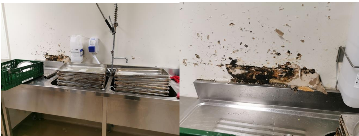
Figure 30 Photos des problèmes d'humidité aux cuisines (novembre 2023)
