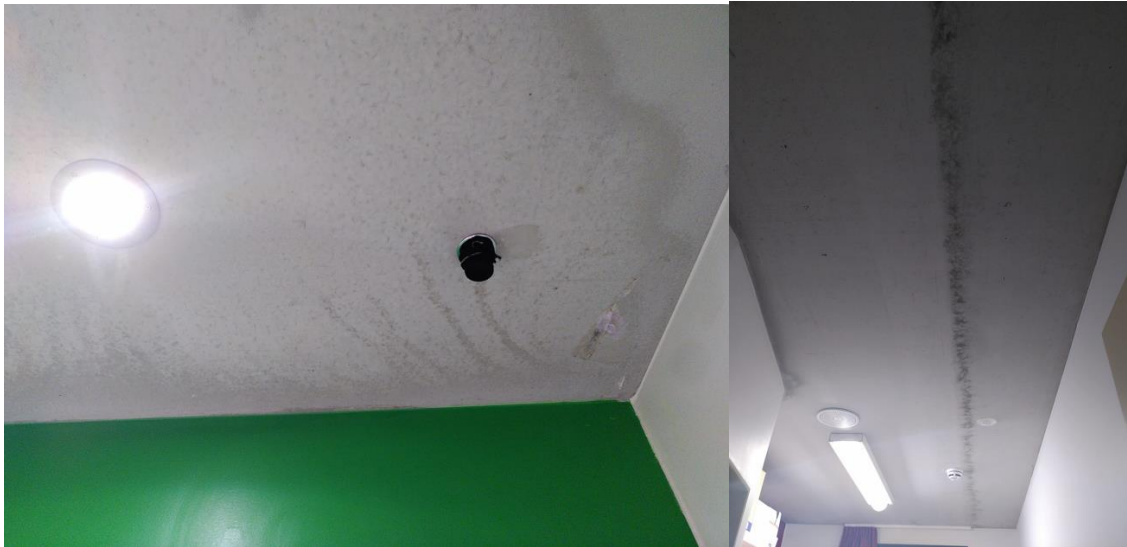
Figure 31 Photos des problèmes d'humidité
